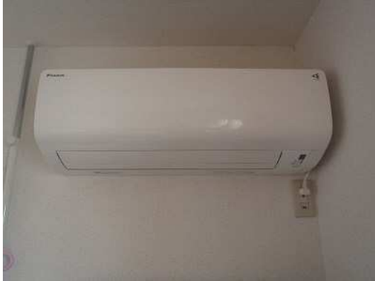
エアコン全体
