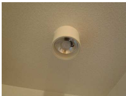
照明全体（天井に取り付け）
