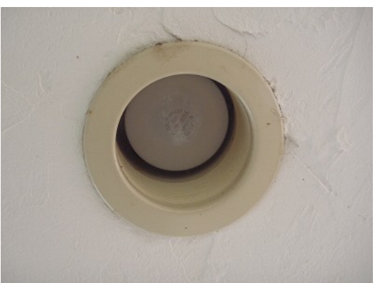
照明全体（ダウンライト）
