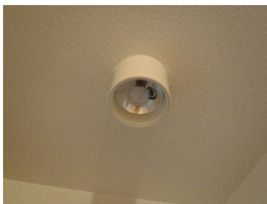
照明全体（天井に取り付け）
