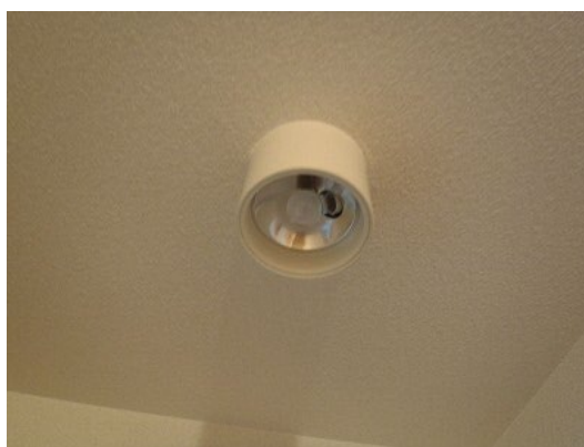
照明全体（天井に取り付け）
