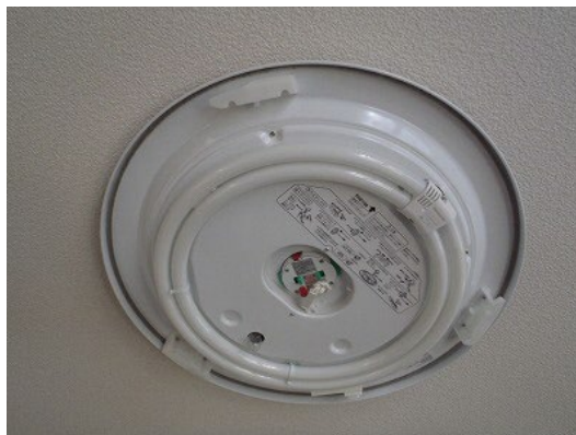
カバーを外した状態
