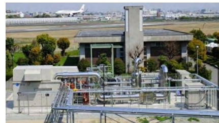
ガスエンジン発電機
