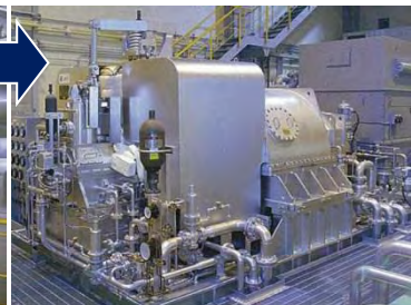
ボイラーで得られた蒸気を利用して、蒸気タービン発電機で発電を行います。
