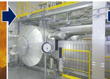
この熱をボイラー内部の水と熱交換して、高温高圧の蒸気をつくります。
