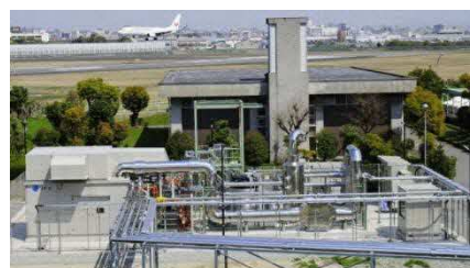
ガスエンジン発電機
