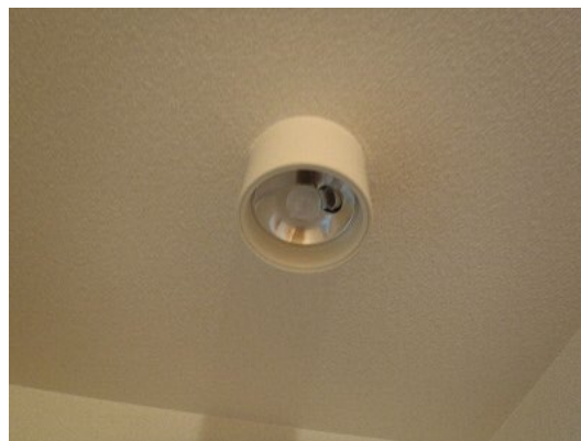
照明全体（天井に取り付け）
